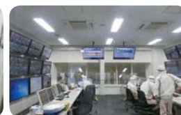
コントローラー室
